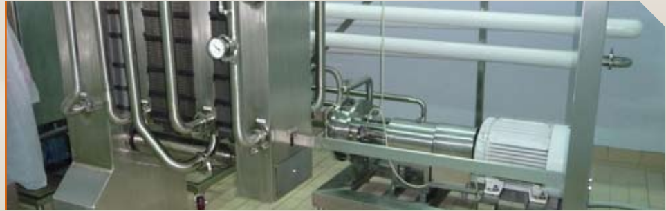
> Intercambiador de calor de placas, golpe de calor y tubos de sostenimiento
