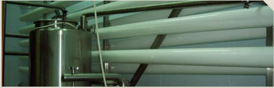
> Tubos de sostenimiento con pendientes y aislamiento
